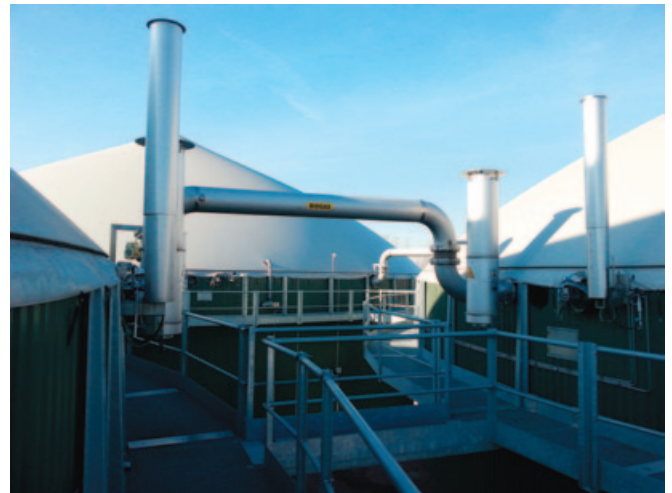
Biogas Galastena Energy a Copparo (Fe)
