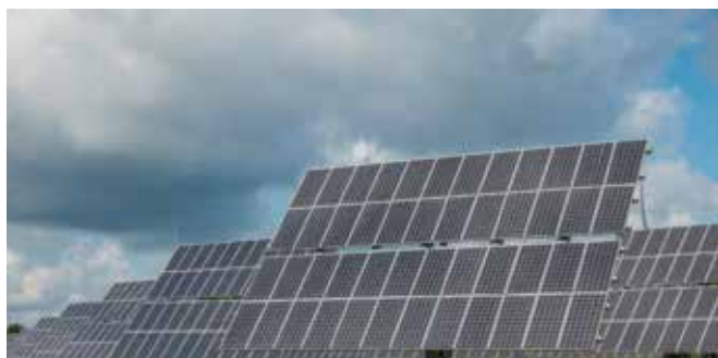
Campo fotovoltaico con tracker
