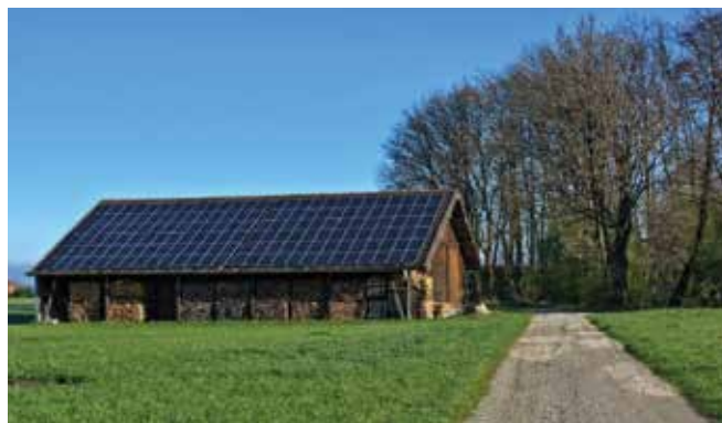
Impianto fotovoltaico su fabbricato rurale
